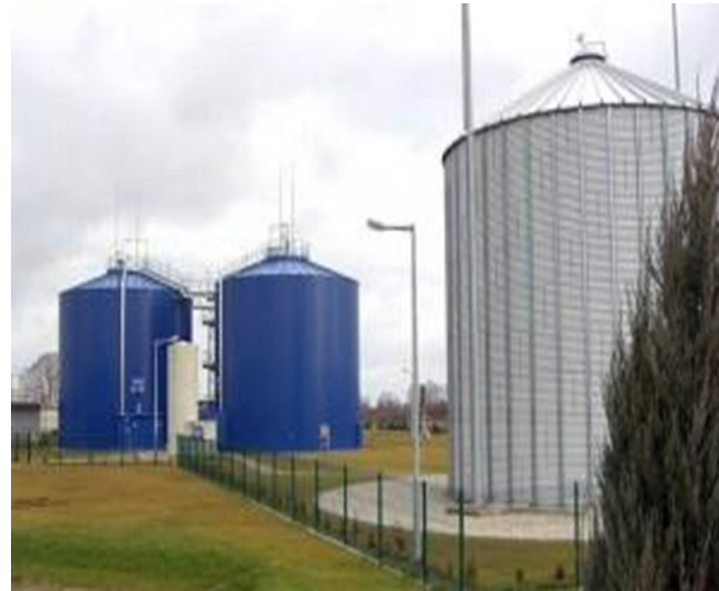
Біогазова електростанція в Івано-Франківській області, 1 МВт
